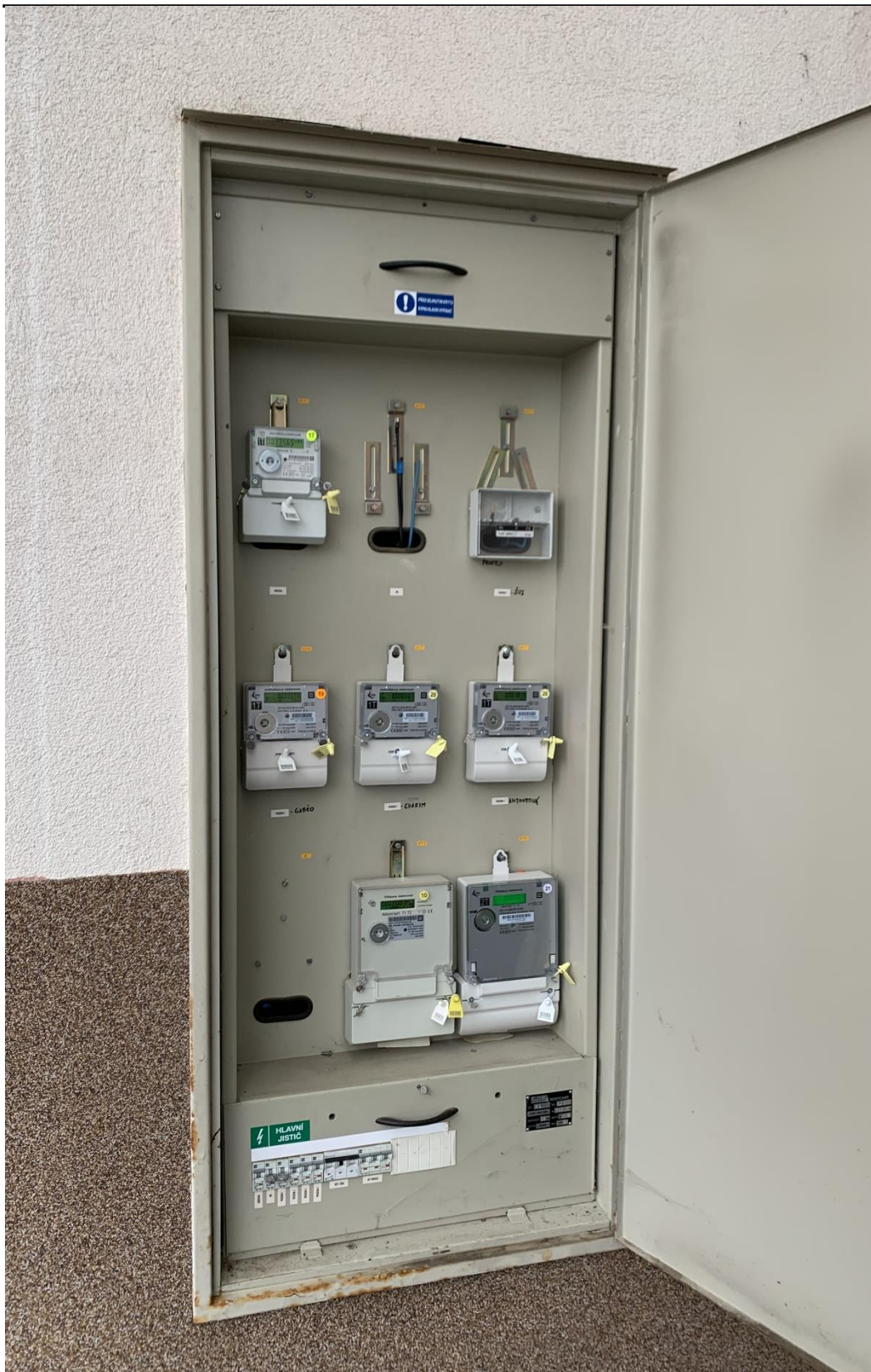
Obr.: Hlavní rozvaděč městský úřad Rotava
