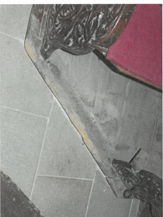
22. Poškození hrany podesty činností dřevokazného hmyzu
