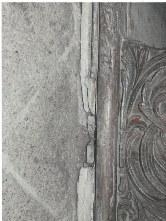
12. Detail lavice. Na snímku je vidět poškození spodní části podešty
