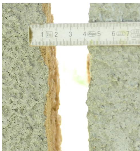
Šíře trhliny cca 40 – 50 mm
