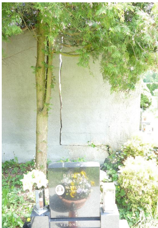
Trhlina – vnitřní strana
