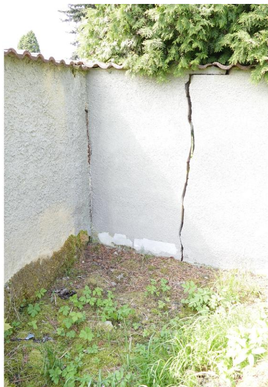
Trhlina – vnější strana
