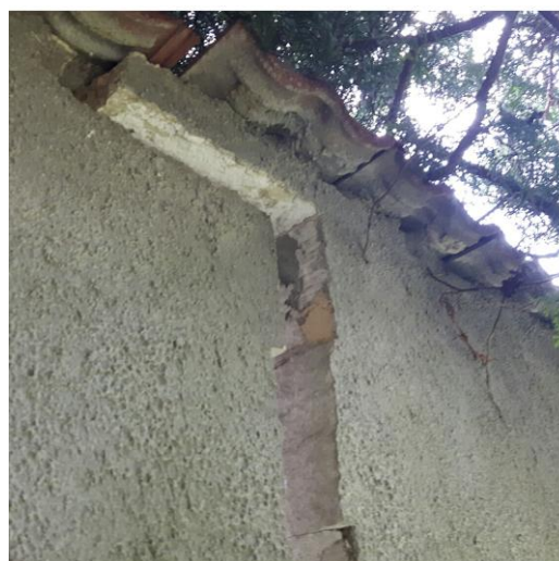
Vybočení zdiva – náklon základu
