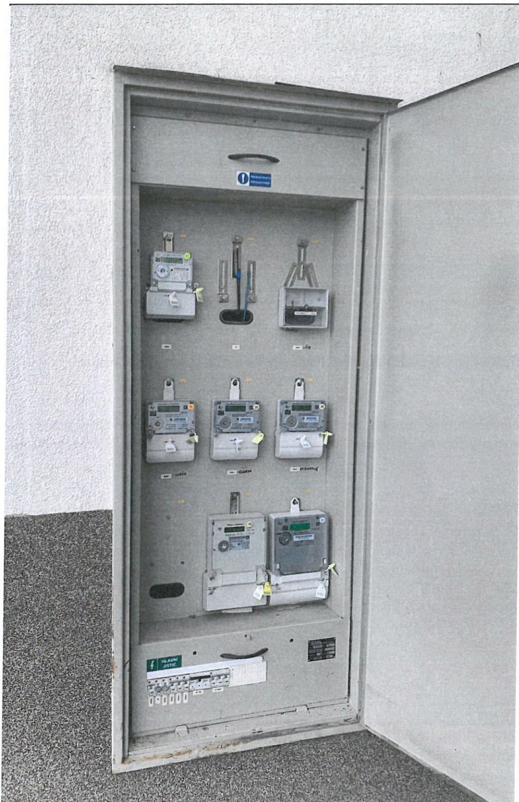
Obr.: Hlavní rozvaděč městský úřad Rotava
