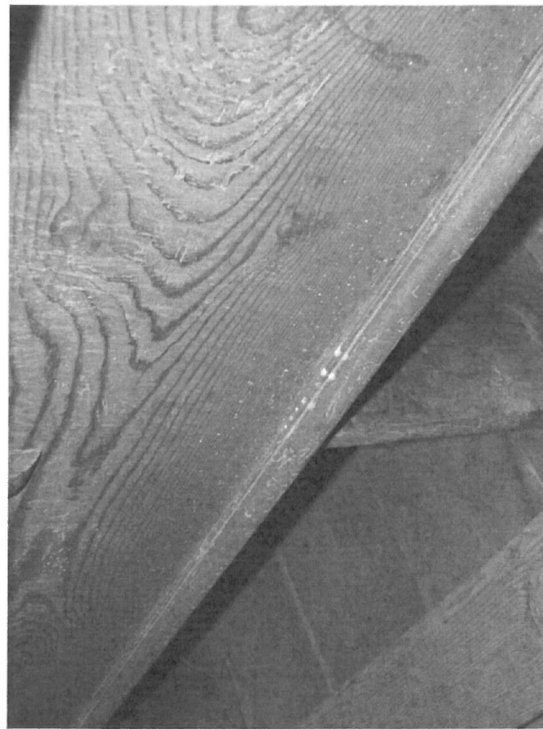
21. Detail lavice. Na snímku je vidět poškození způsobené dřevokazným hmyzem na místě ukotvení bočnice do podesty
