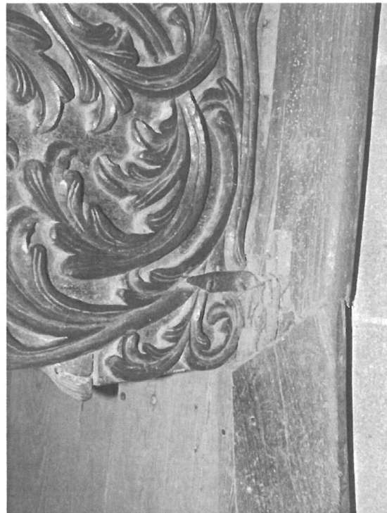
19. Detail poškození v místě napojení bočnice lavice na podestu
