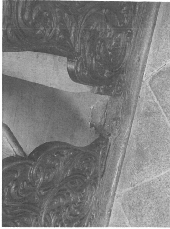
23. Detail poškození podlahy podesty
